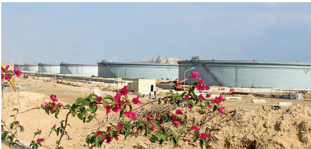
نمای مخازن پروژه
