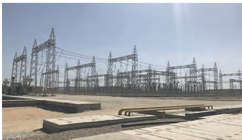
پست برق پروژه در بهره برداری
